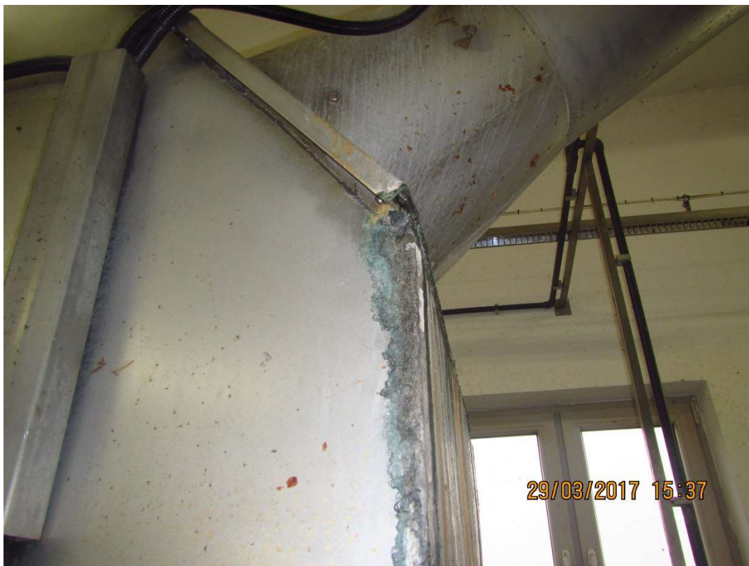
Korozja i wycieki z komory sita
