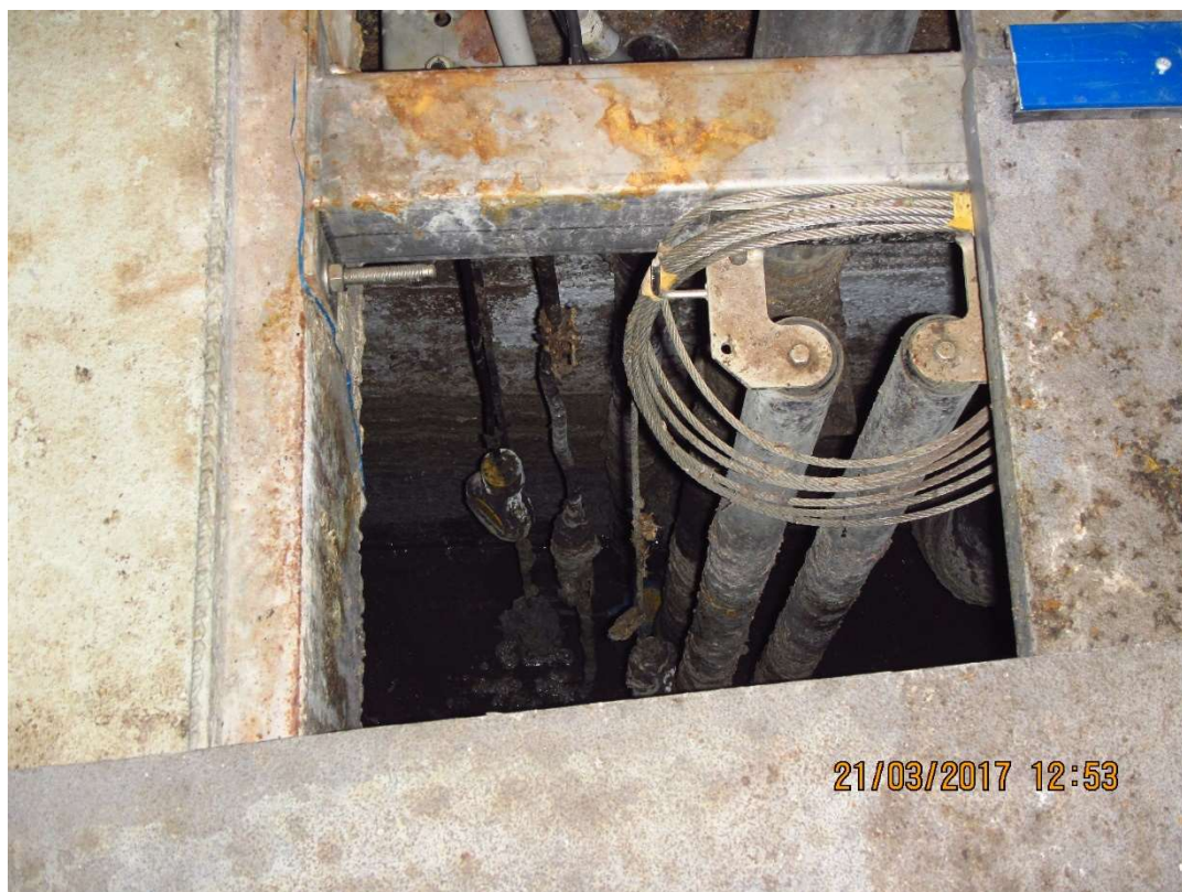
Widoczne naloty tłuszczu
