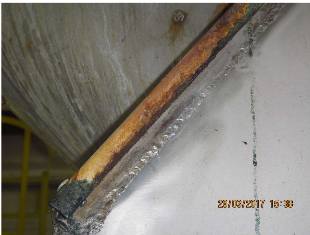
Korozja i wycieki c.d.
