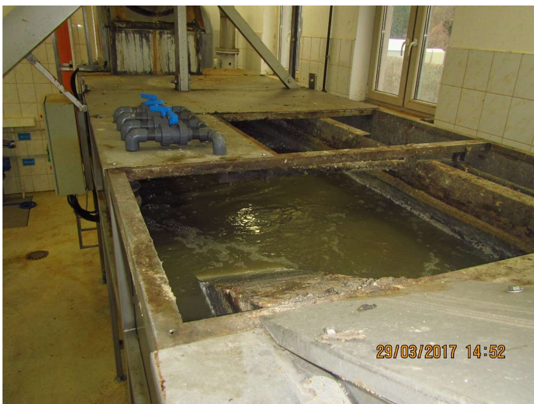
Otwarta komora piaskownika. Przenośnik ukośny piasku w środku komory utrudnia usuwanie tłuszczu i cyrkulację cieczy. Widoczna korozja poszycia.
