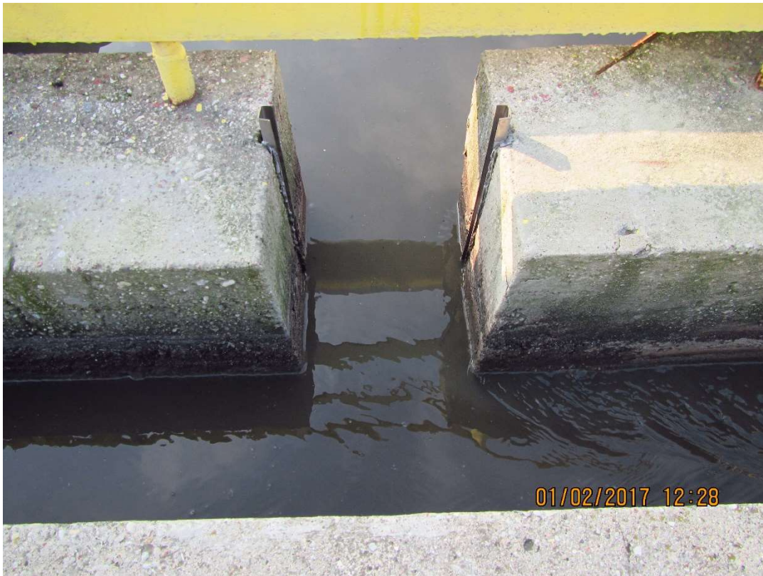
Zastawka na wylocie z osadnika. Brak zawieradła i pokrętła do obsługi
