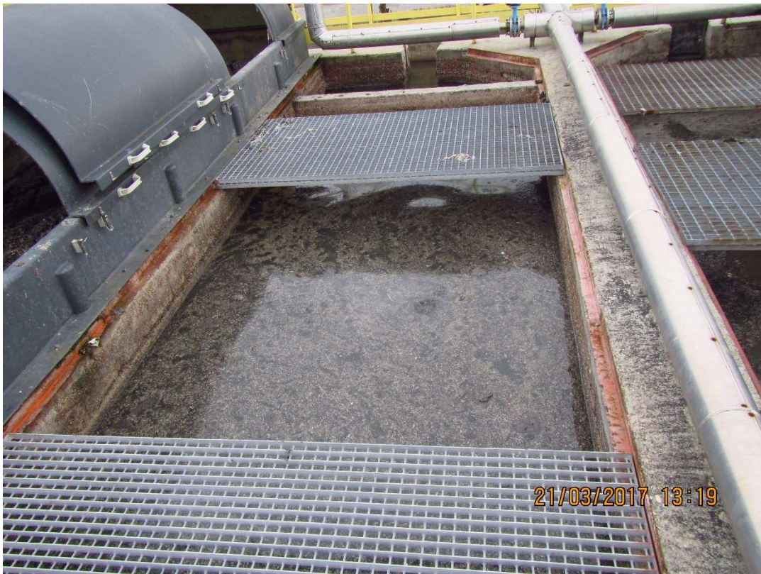
Widoczne grudki tłuszczu w korycie przepływowym
