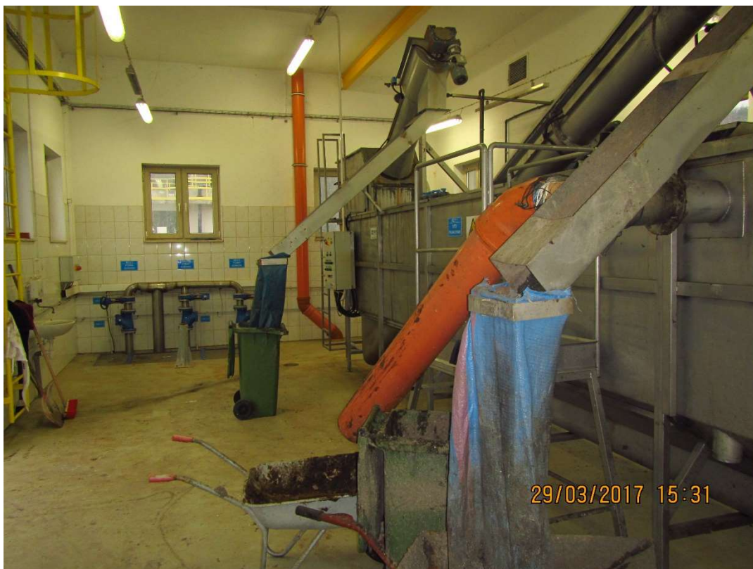
Widok ogólny odbioru odpadów. Całkowity brak hermetyzacji.
