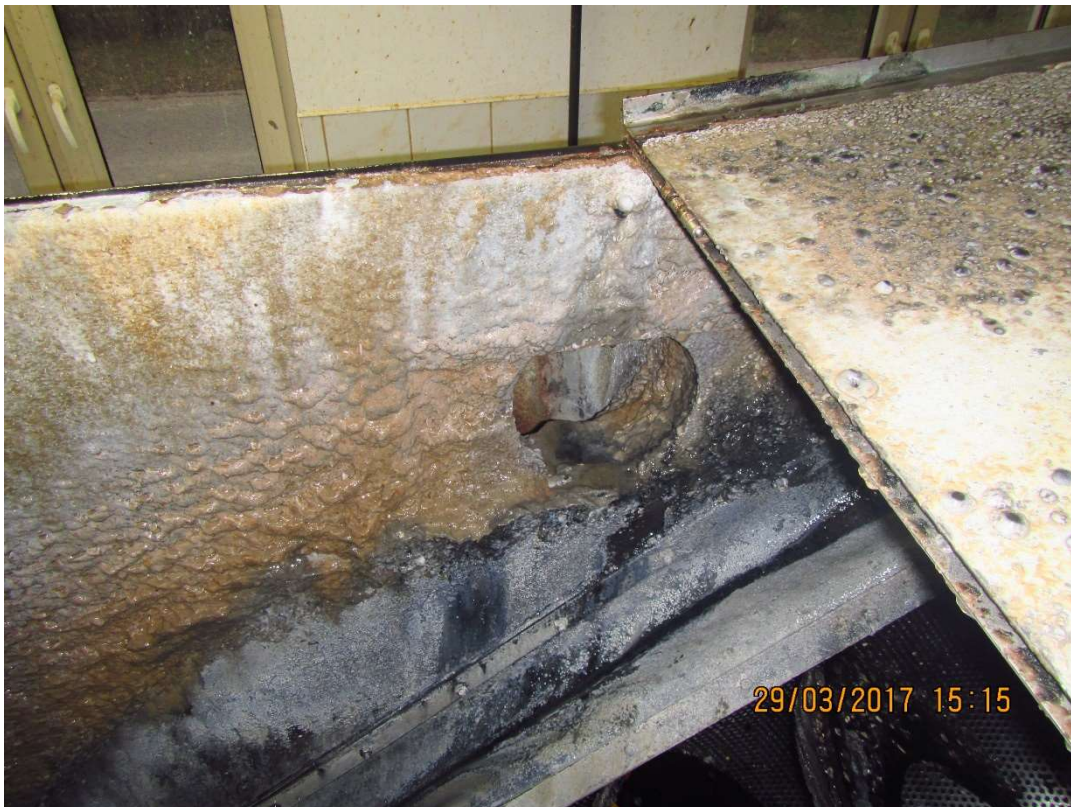
Przelew awaryjny sita, przy maksymalnym dopływie jest możliwe przelanie się ścieków przez górną krawędź komory.
