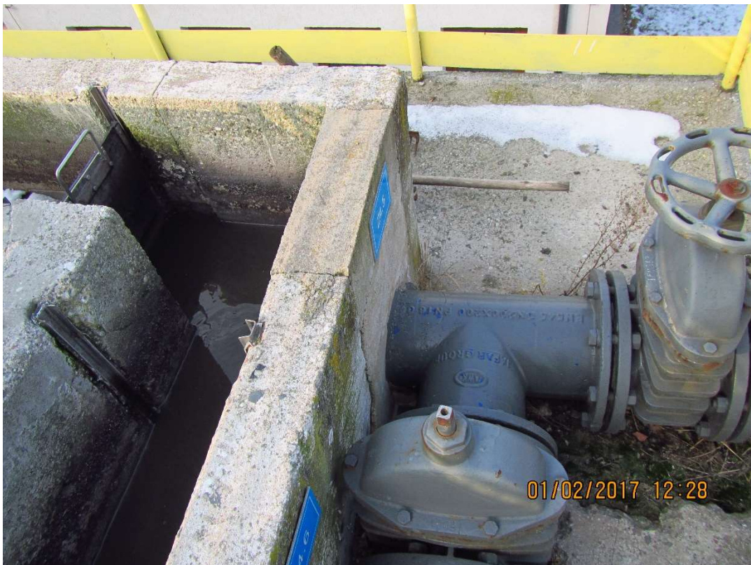
Zastawka na kanale obiegowym. Konstrukcja szybrowa – niezgodna z PFU.
