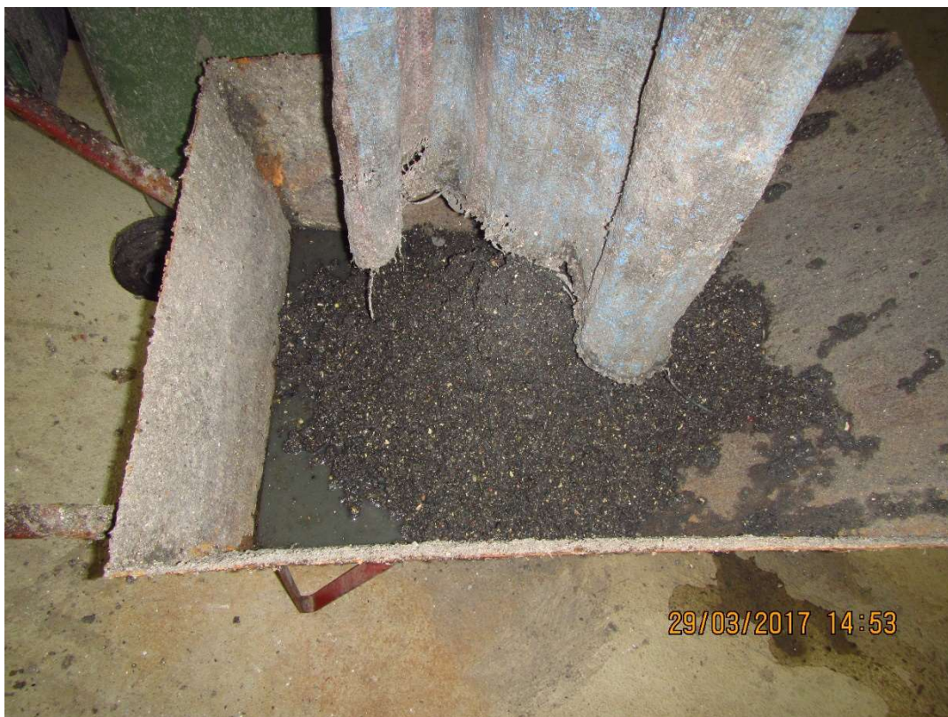
Zatrzymany piasek. Widoczne jezioro ścieków i części organiczne.
