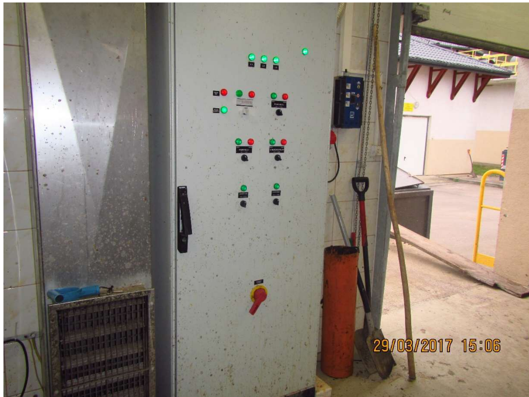
Ochłapane tłuszczem i ściekami panel sterowania i kanał wentylacji. Naruszenie zasad higieny na skutek zastosowania takiego sposobu usuwania tłuszczu z piaskownika.
