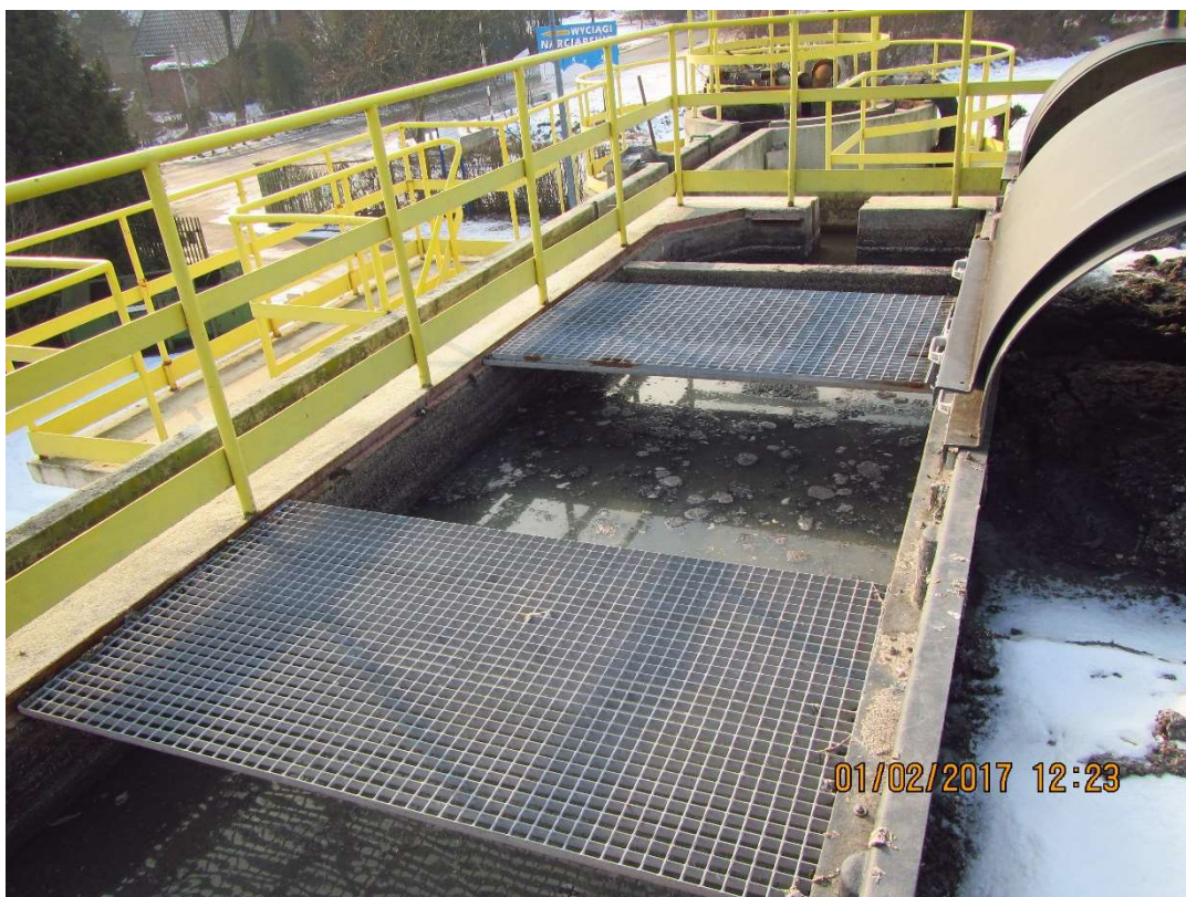
Pomost obsługowy koryta osadowego. Brak wejścia na pomost obsługowy. Brak rozwiązania czyszczenia koryt przepływowych.
