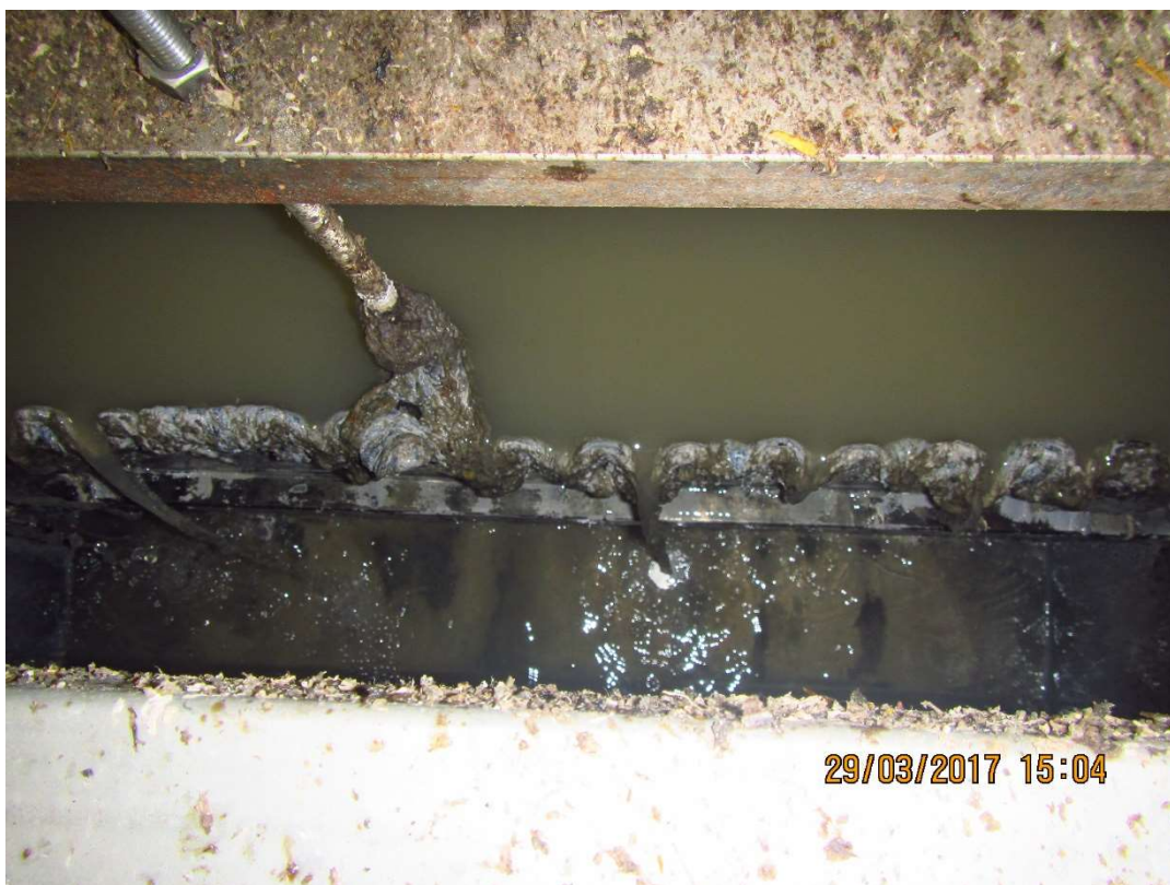
Zastawka na odpływie. Widoczne zanieczyszczenia włókniste, które przepłynęły przez sito 6 mm. Potwierdza to niewłaściwy rozmiar oczka sita dla takiej jego konstrukcji. Zamawiający wymagał 2 mm.
