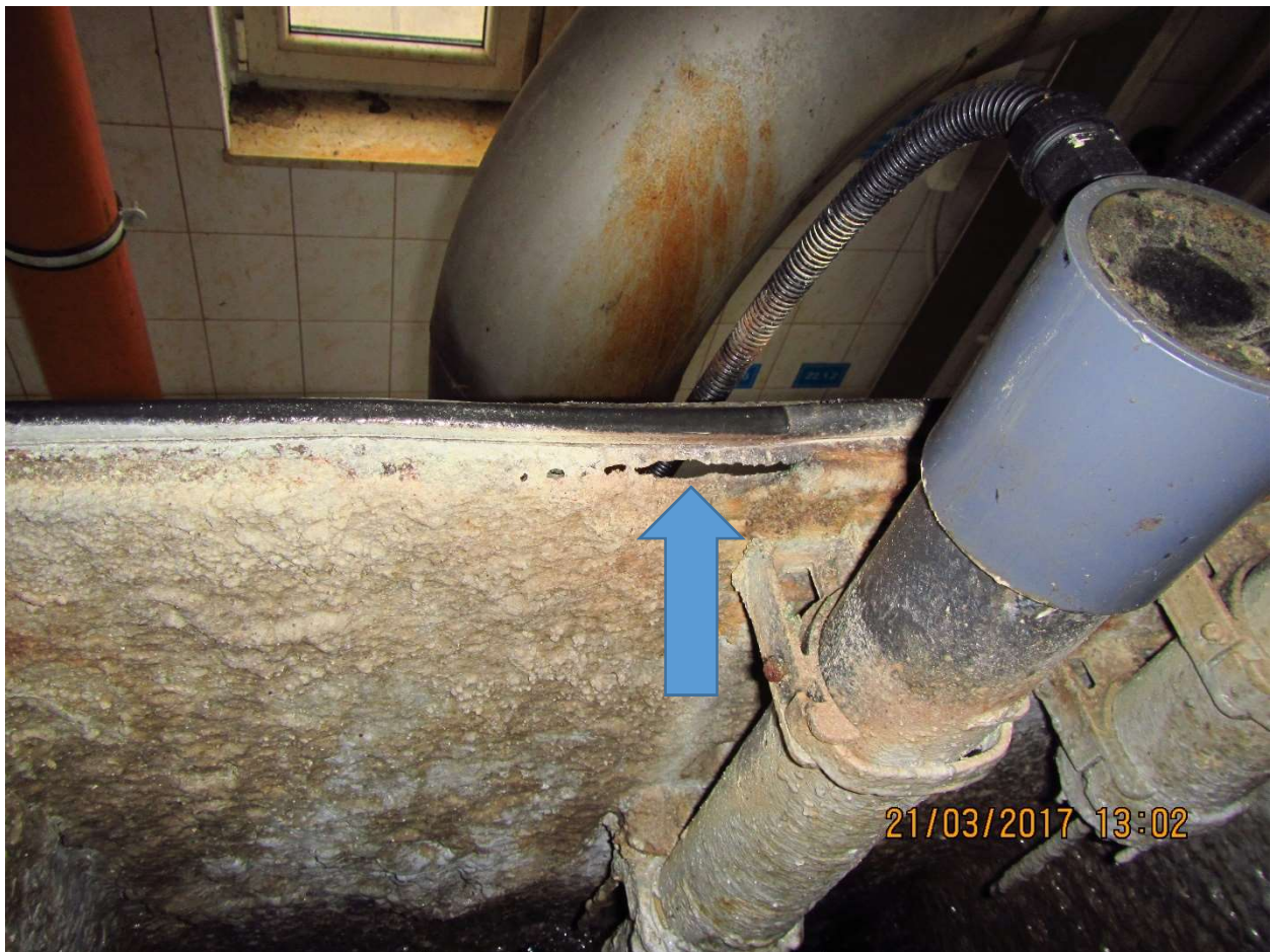
Perforacja komory sita.
