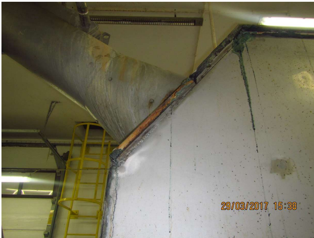
Korozja obudowy sita c.d.
