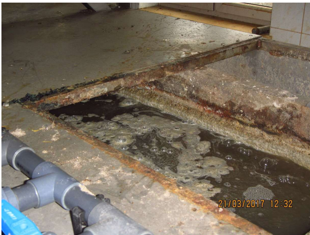
Korozja w komorze piaskownika.
