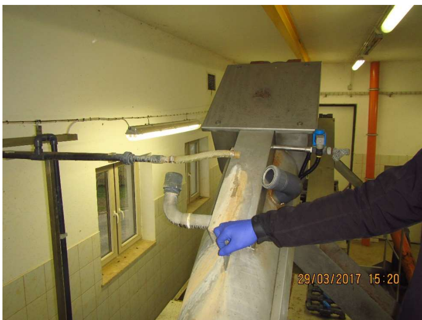
Przerwane doprowadzenie wody do płukania skratek
