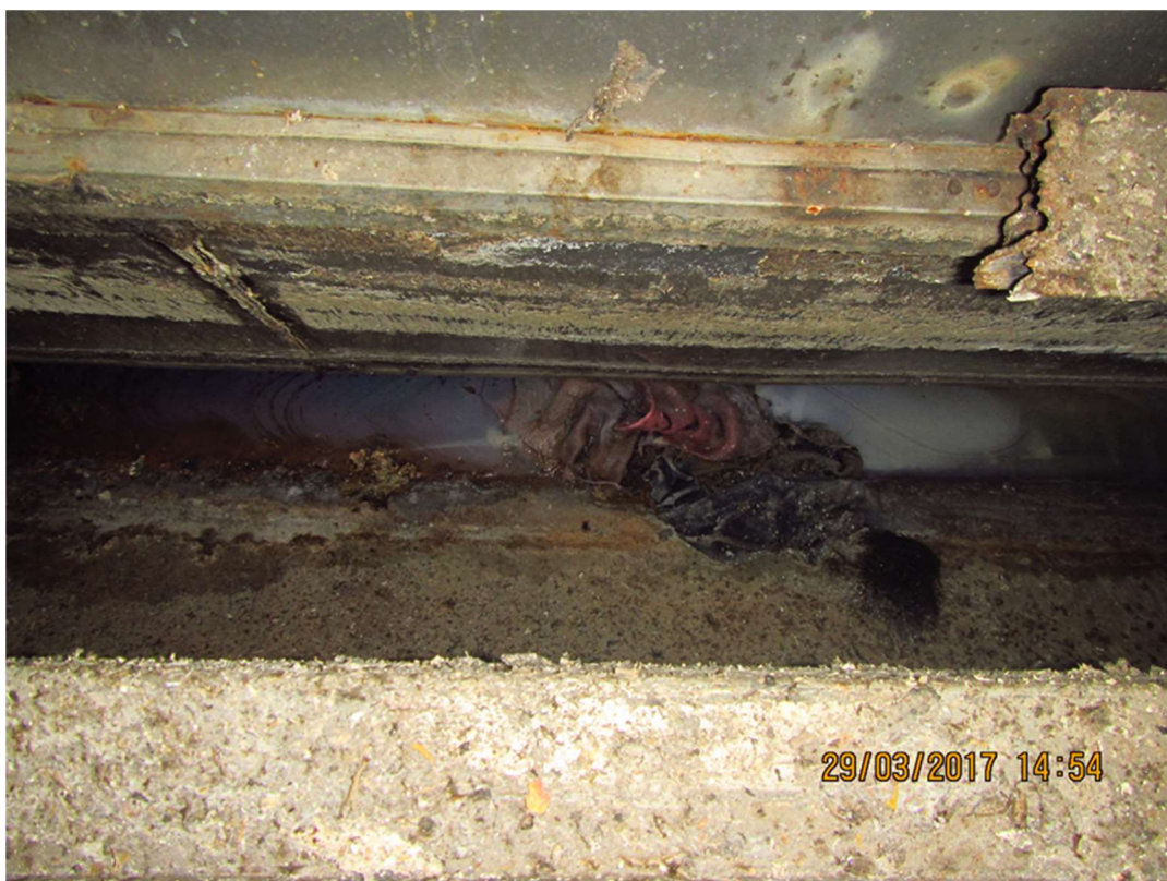
Korozja w kieszeni tłuszczowej
