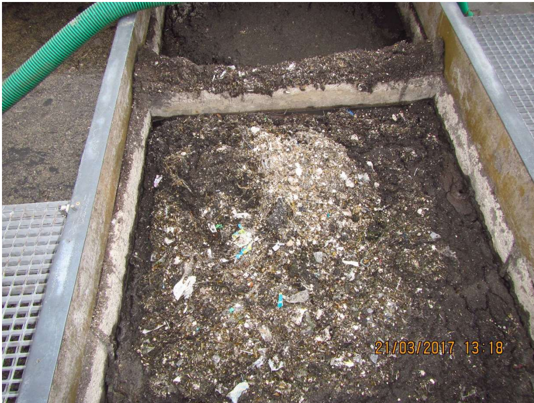
Widoczne kawałki tłuszczu i skratki które przepłynęły przez węzeł mechaniczny.
