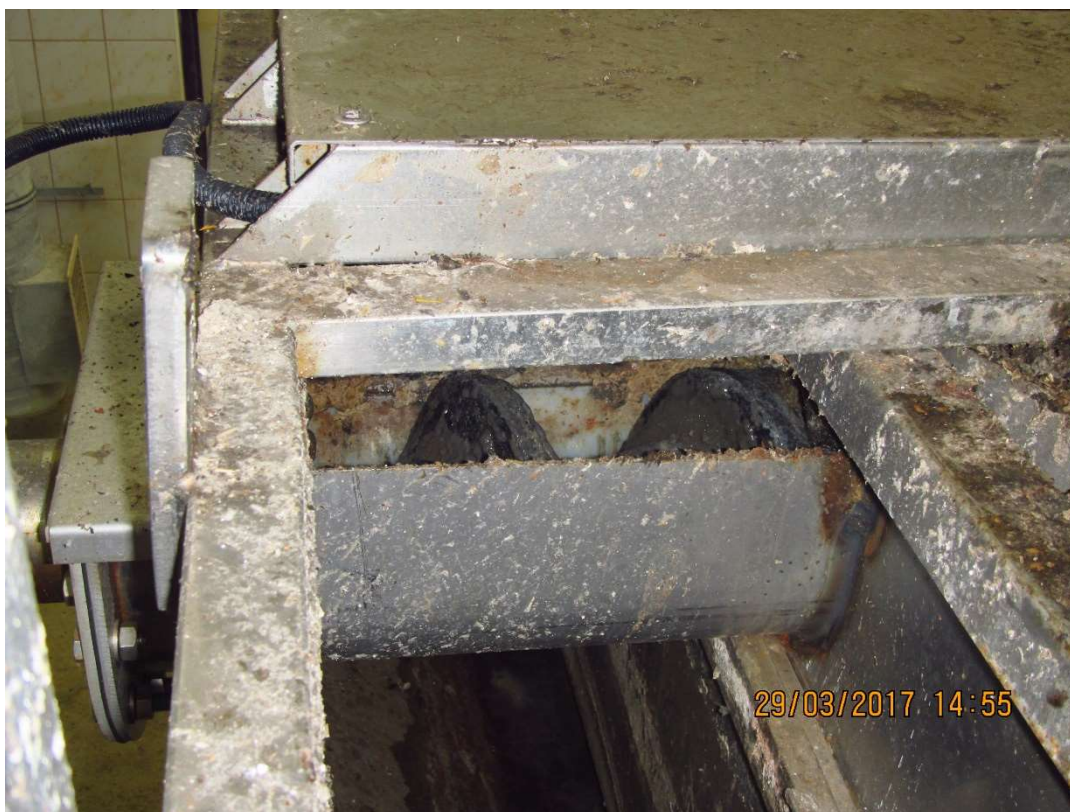
Nagarniacz tłuszczu. Korozja w komorze piaskownika i komorze tłuszczowej
