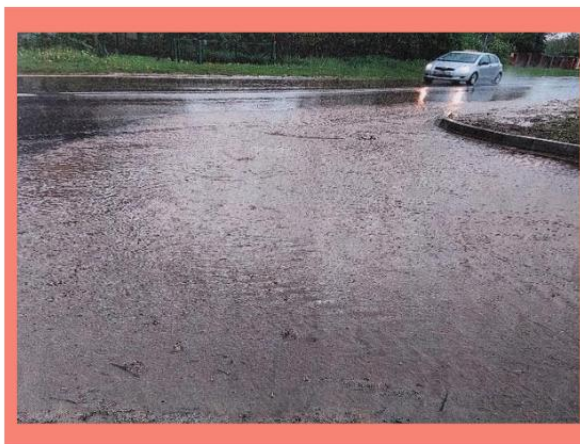
EFEKTY NIEPRAWIDŁOWEGO SYSTEMU ODWODNIENIA
